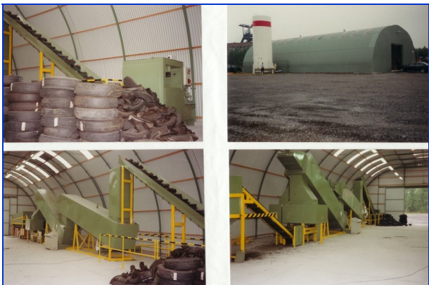
Cryogene Recycling-Anlage für Alt-Reifen der Firma AGA 10
